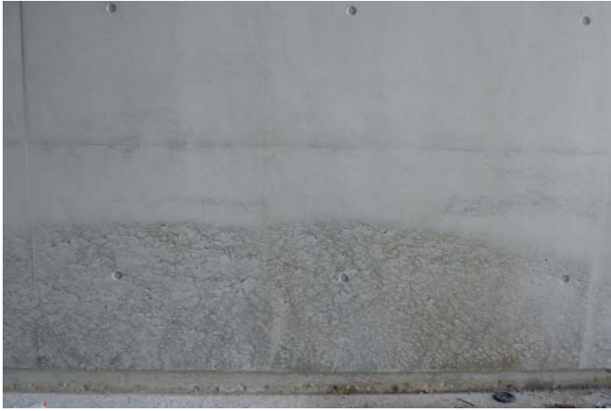
Sichtbetonflächen vor der Restaurierung
